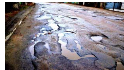
Рис.1. Дороги с ямами
